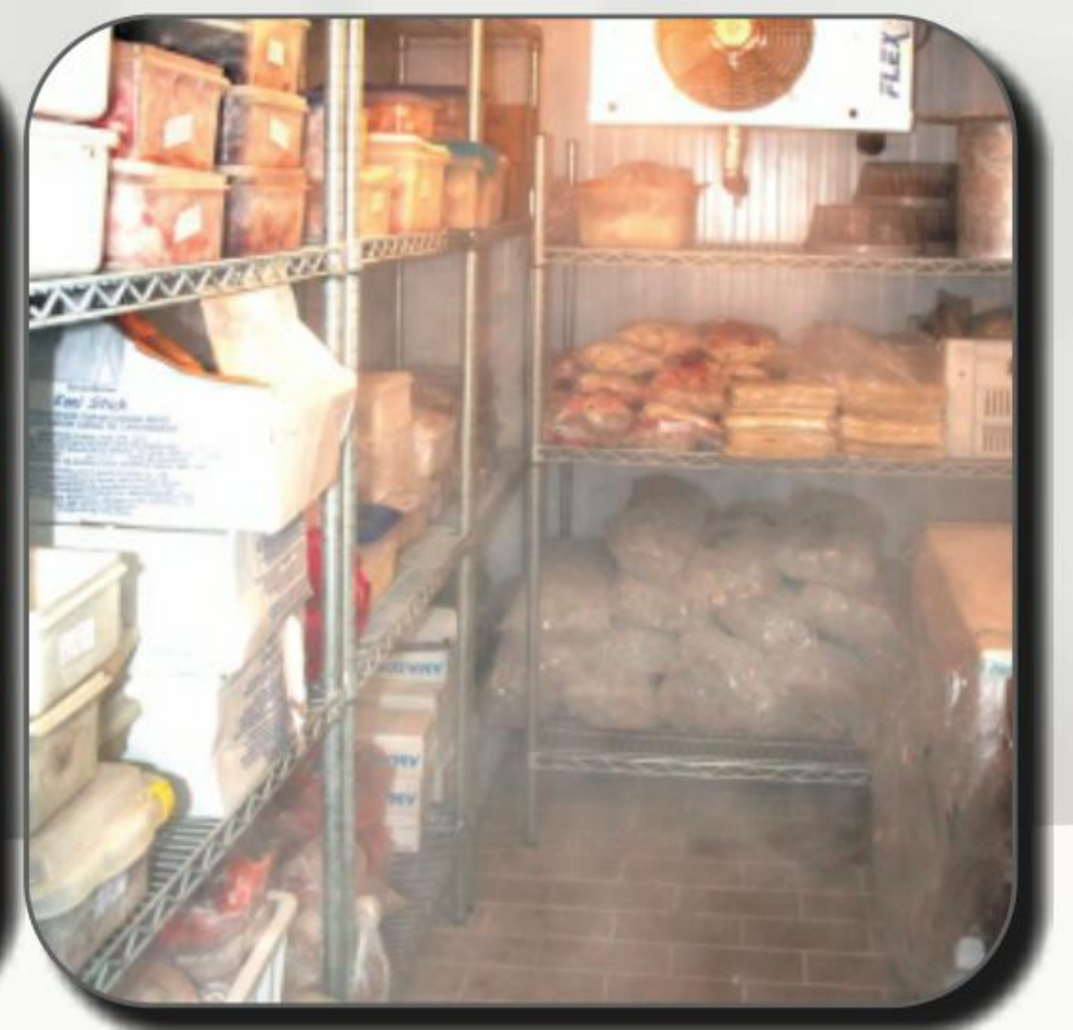
CÂMARA FRIA Câmara Fria // Cold chamber
